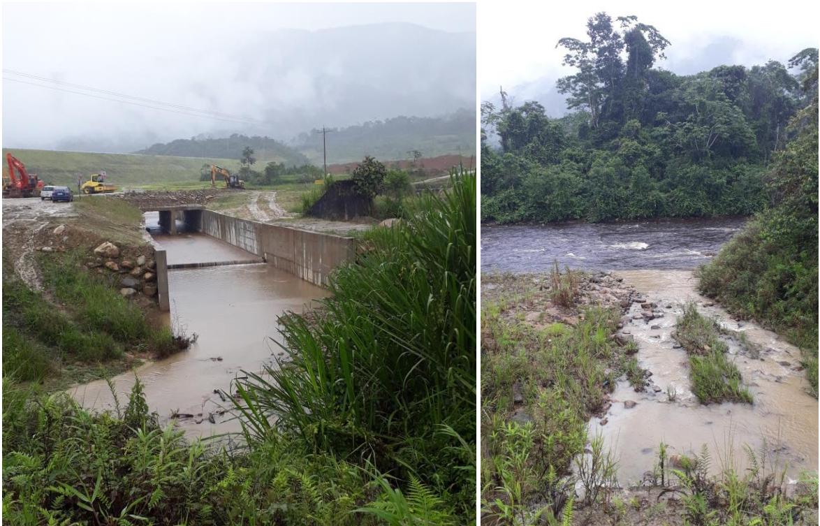
Figura 9: Canalización del Río Tundayme y descarga de agua turbia desde el proyecto hacia el Río Quimi. Fuente: Colectivo de Geografía Crítica del Ecuador 2019.
